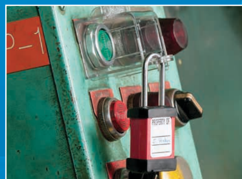
S2153 sécurisé à l'aide d'un cadenas S31REDCOV.
